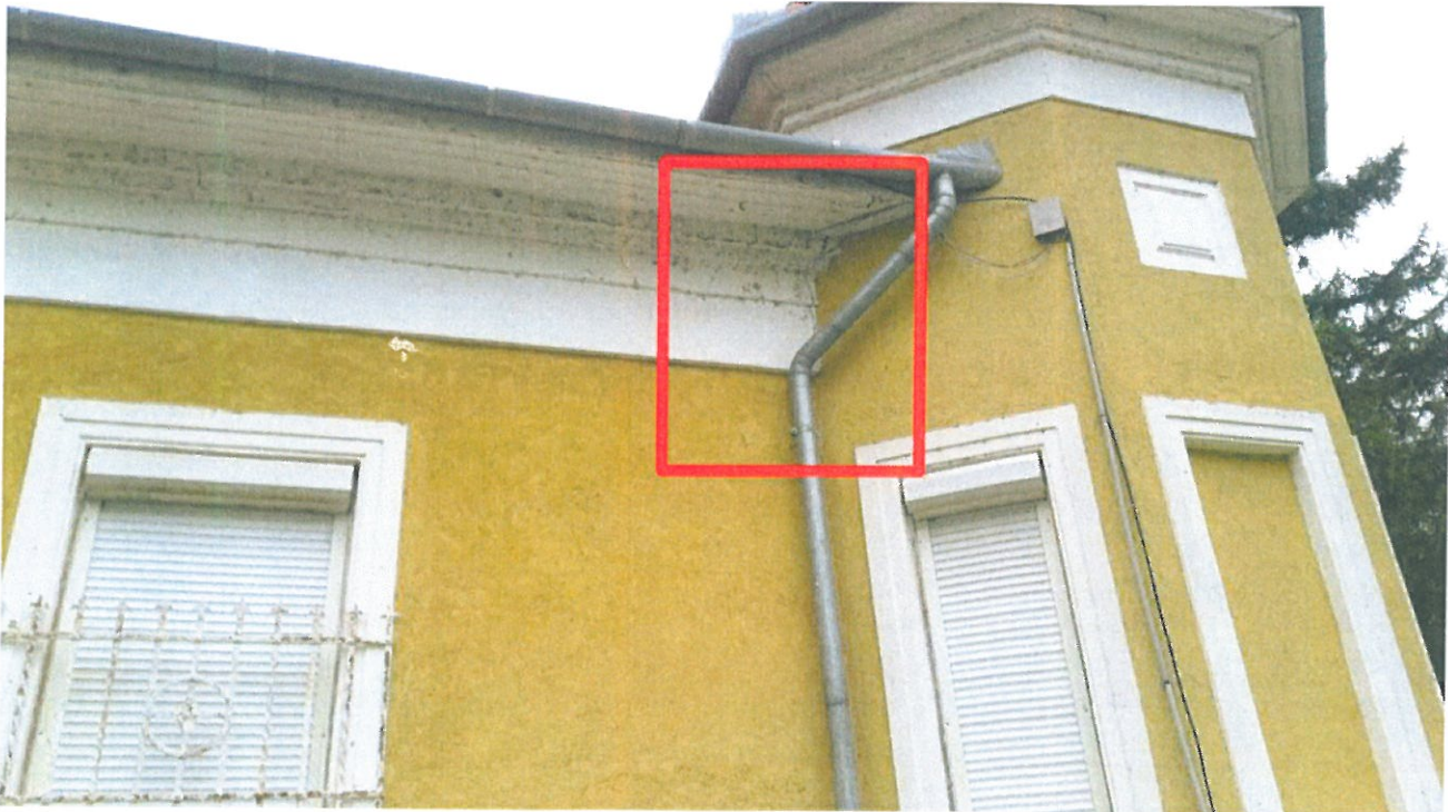
7. kép, Torony szerkezeti lerepedése
