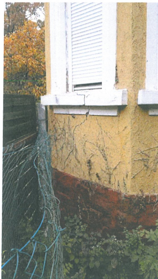
11. kép, Déli oldali szerkezeti repedés 24mm! Oldal 16 / 24
