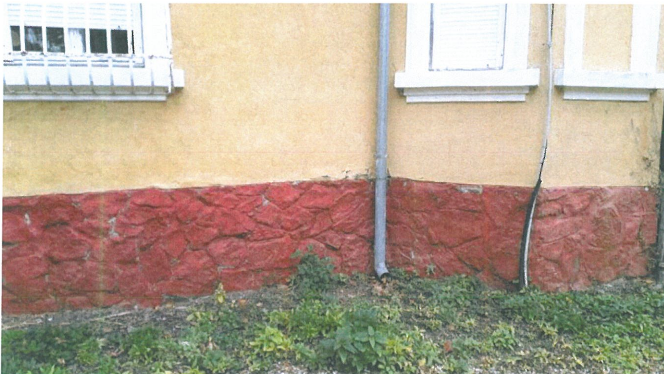
8. kép, Torony nyugati oldali lábazati szétrepedése
