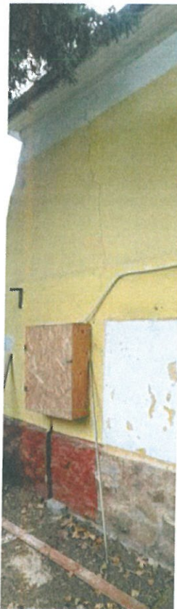
2. kép, Oldalfali függőleges átmenő repedés
