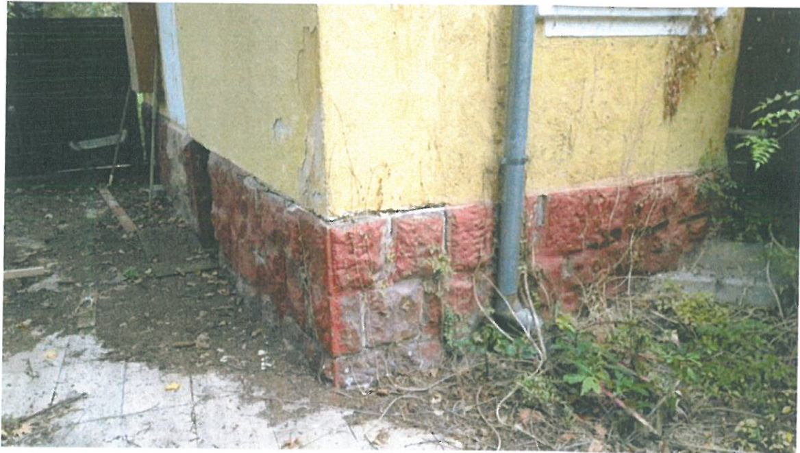
4. kép, Lábazat lerepedése, szerkezeti átrepedés és felázás helyén
