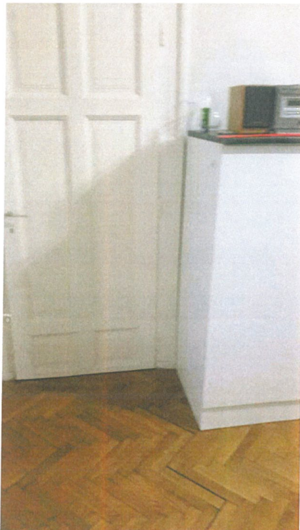
14. kép, Belső padló repedés, fal folytatása
