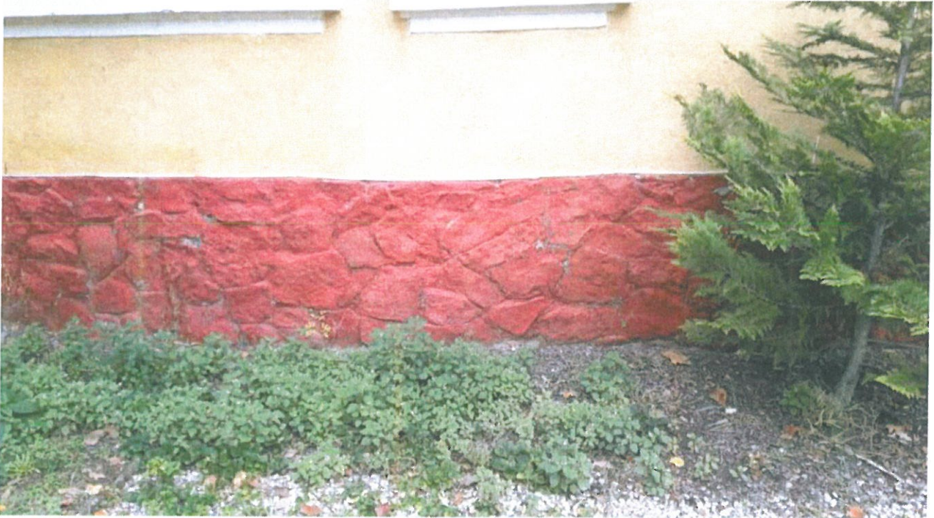
6. kép, Lábazat ferde repedése
