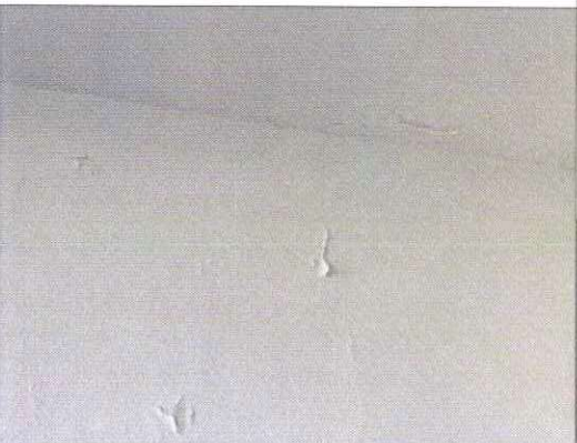
Repedések a falon
